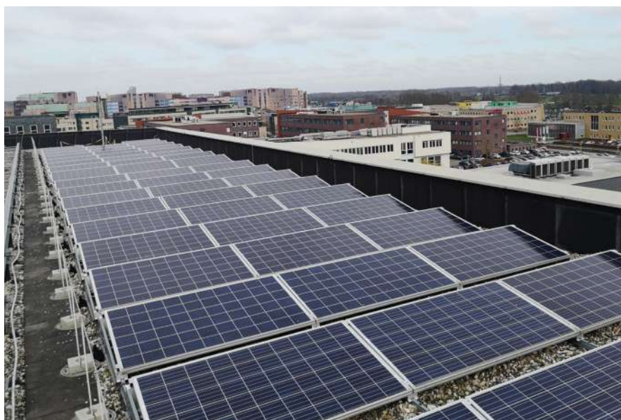
Figuur 5: Zonnepanelen op het dak bij WDO Delta
